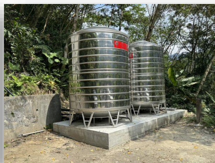
圖 二十七、瀑布公園旁 2 座蓄水塔，讓瀑布社區及野要街居民用水更穩定
